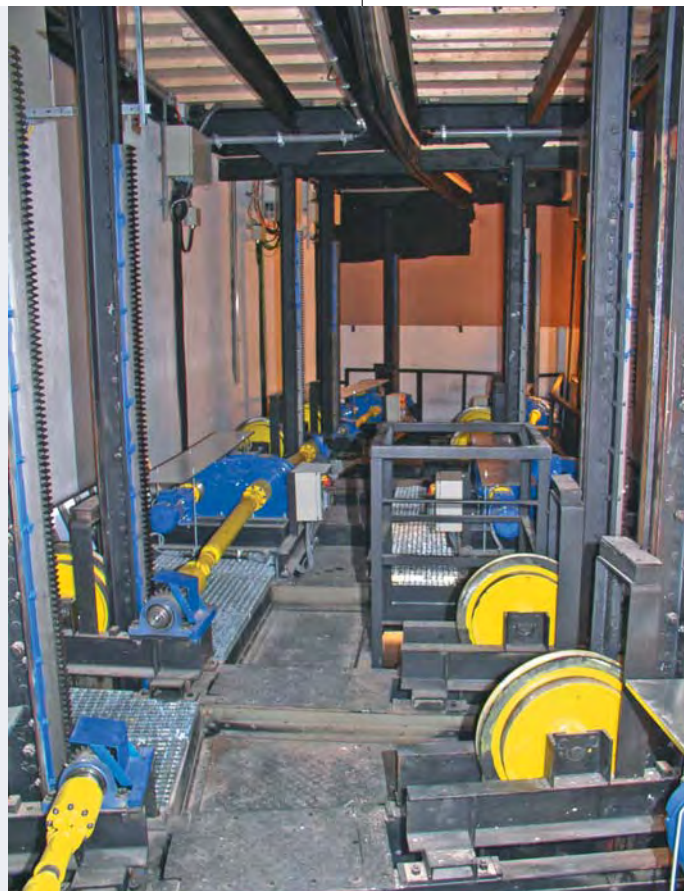
Der neue Antrieb in der tiefergesetzten Antriebsebene
