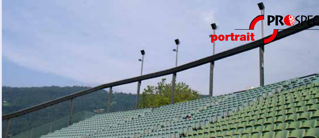
820 Lautsprecher umgeben den Zuschauerraum der Seebühne
