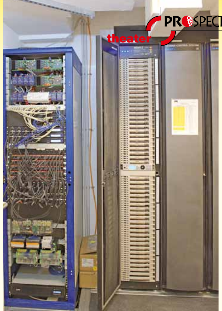
Blick in den Dimmer-Raum mit den ETC Sensor-Dimmern (242 Kreise)
