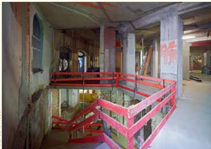
Aus den engen Gängen des früheren Eingangsbereiches ist nach Entfernung nicht tragender Wände ein einziger großer Raum geworden. Zusätzlich wurde der Boden durchbrochen, um einen Zugang zur Lounge im Keller zu schaffen
