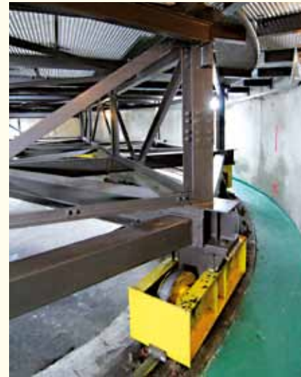
Die gesamte Last der Drehbühne wird von diesen Rollen getragen – Zustand vor der Sanierung
