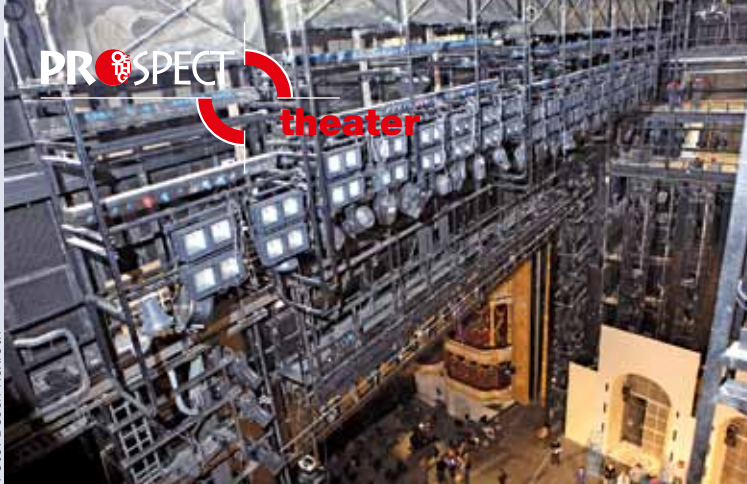
Fünf vertikal verfahrbare Beleuchterbrücken mit mehrteiligen Beleuchtergestellen leuchten die Hauptbühne aus
