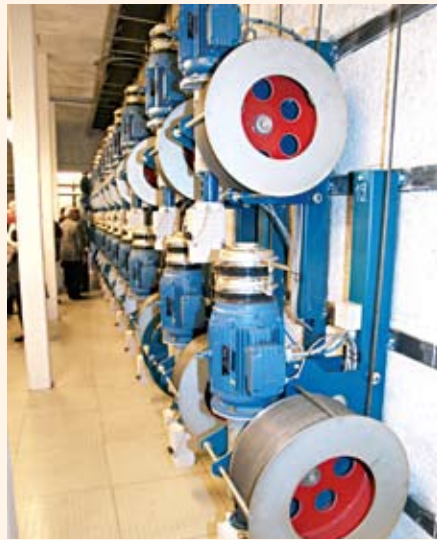
Maschinenraum unterhalb des Bühnenbodens mit den Prospektzugwinden
