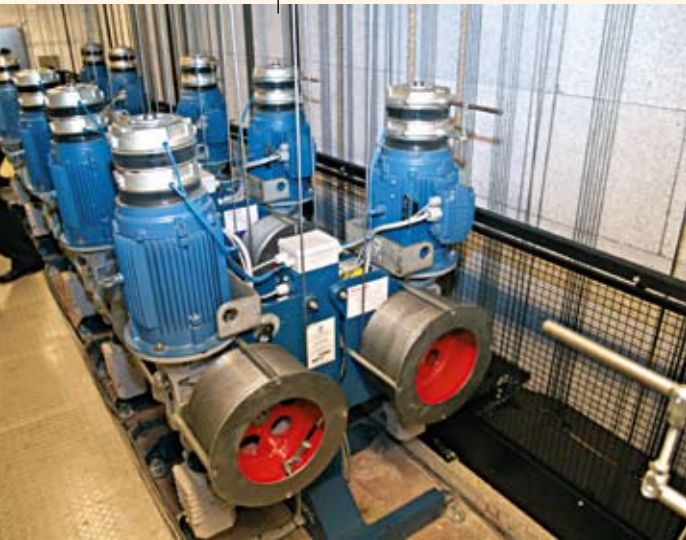
Maschinenraum im Bühnenturm mit den Punktzugwinden
