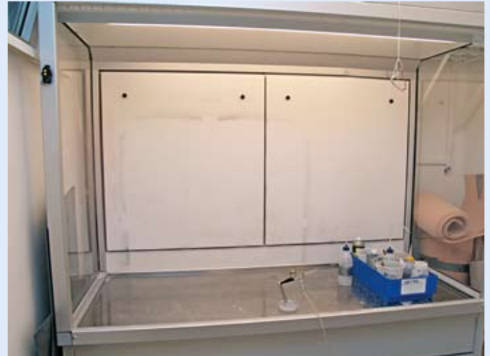
Der Arbeitschrank mit der Absaugeinrichtung für das Arbeiten mit Lösungsmitteln oder Farben
