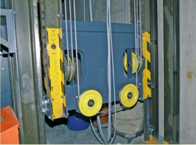
Die alten Triebstöcke (gelb/schwarz) wurden als Heber weiterverwendet und an ihnen die Rollen des 5-fach eingesicherten Seilantriebes montiert
