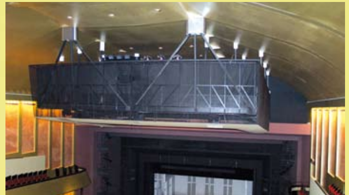
Die Beleuchterbrücke ist an der Decke abgehängt.
