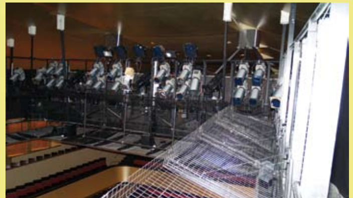
Die mit Scheinwerfern bestückte Beleuchterbrücke
