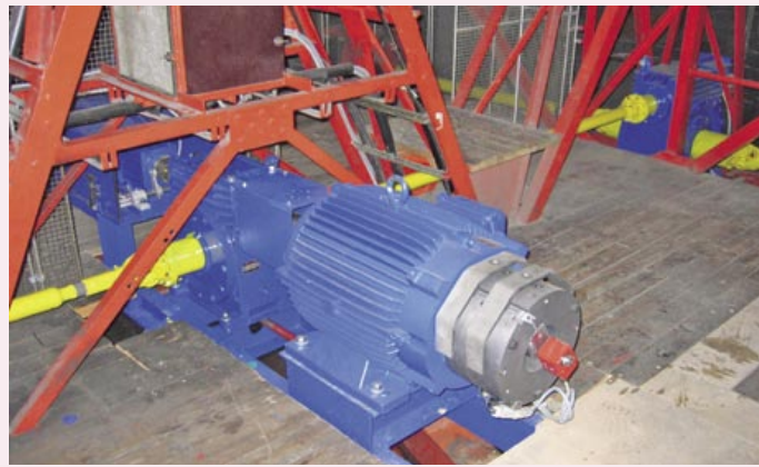
Neuer Hubantrieb mit 37 kW Drehstrommotor und angebauter Doppelbremse, Zentralgetriebe und Gelenkwellen
