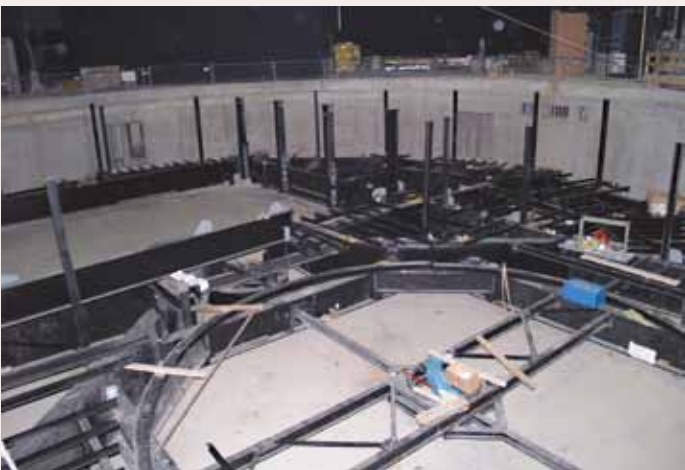
Die im Aufbau befindliche, riesige Transportdrehbühne mit den Ausnehmungen für die Spieldrehbühne (rechts vorne) und die 3 Podien (links im Hintergrund) im September 2011
