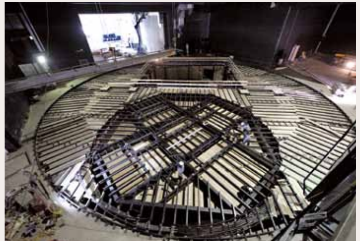
Die Spieldrehbühne schon in einem finalen Bauzustand; dahinter die Öffnung für die 3 Hubpodien
