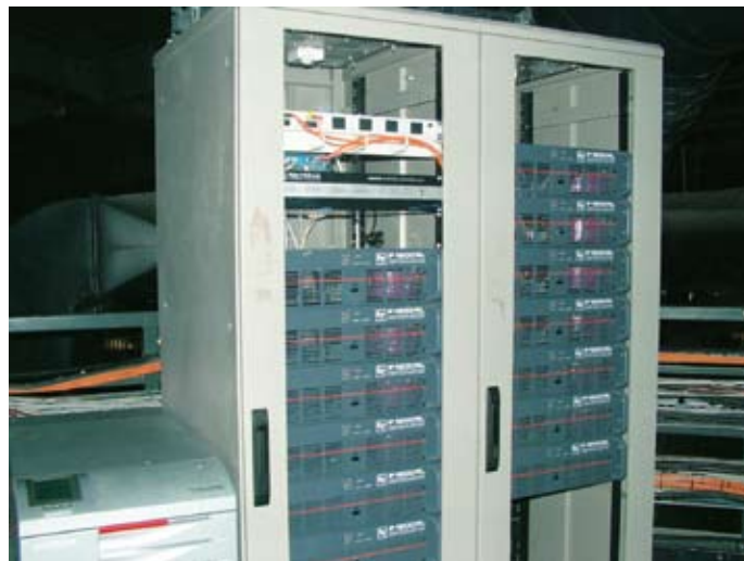
Enorme Power im Kontrollraum: Mehr als 50 P1200RL-Endstufen sind dort im Einsatz
