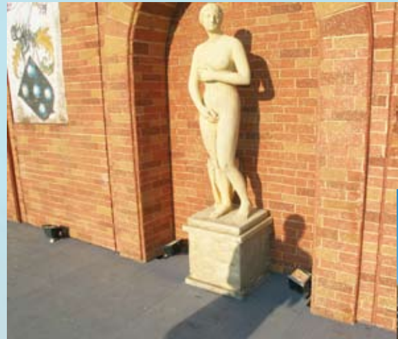
Die kleinen Fluter für die Fassadenanstrahlung
