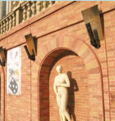
Die neuen, TÜV-geprüften, Gasfackeln
