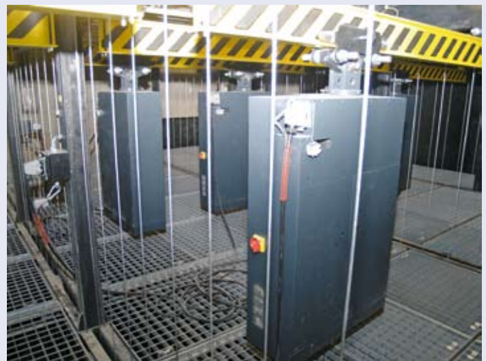
Die verfahrbaren Punktzugwinden „Fly“ am Schnürboden des Ronacher
