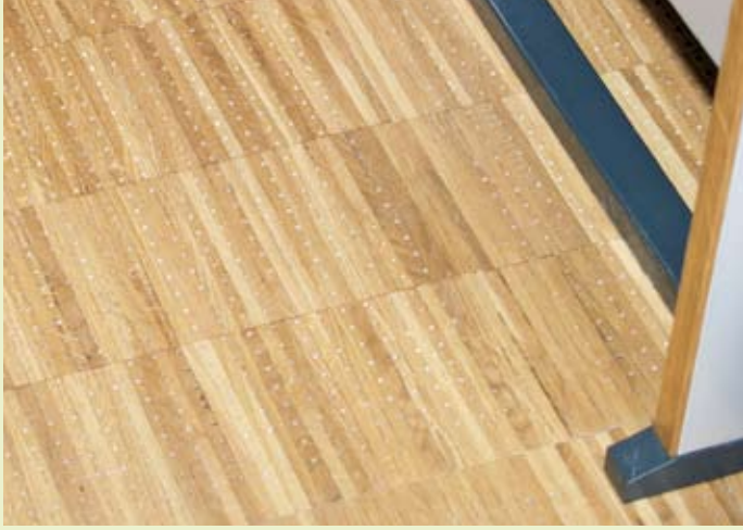
Über Löcher im Saalboden wird konditionierte Luft eingeblasen
