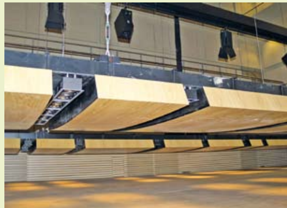
Die herabgelassenen Akustiksegel mit der Bühnenbeleuchtung
