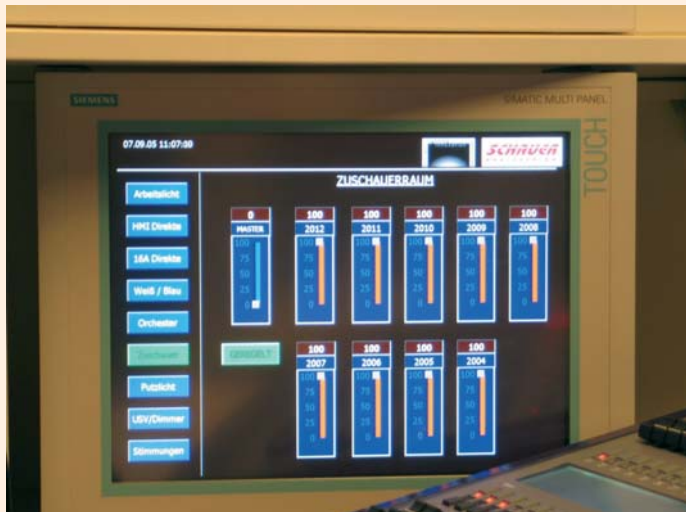
Touchscreen in der Lichtregie für die SPS-Steuerung
