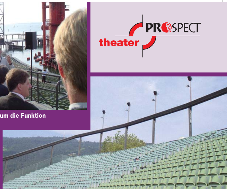
Die 820 Lautsprecher von Kling & Freitag wurden rund um die Zuschauertribüne installiert.
