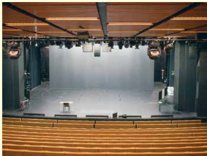
Die gesamte Lichtsteuerung erfolgt über EtherCAT
