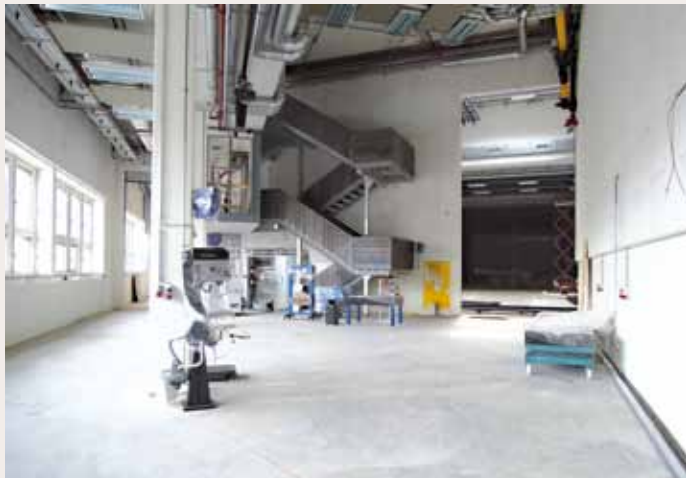
Die Schlosserei steht kurz vor der Inbetriebnahme
