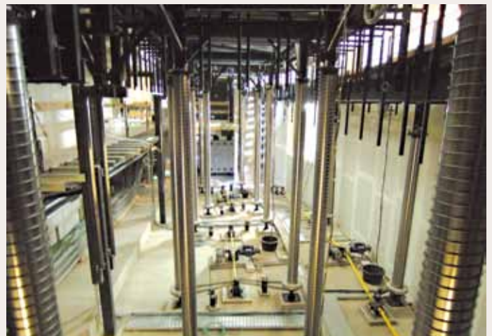
Die „aufgeräumte“ Untermaschinerie der Orchesterpodien mit Faltspindelantrieben
