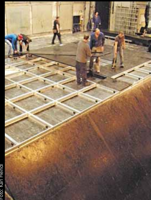
Bild links und oben: Die eigentliche Spielfläche wird auf der Bühne zusammengeschaubt, beplankt und dann an Seilen hochgezogen
