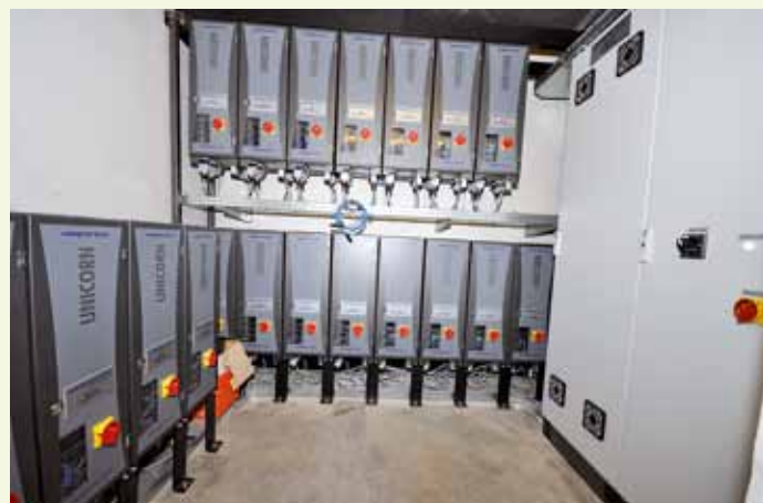
Die UNICORN-Schaltanlagen von Wagner-Biro: Sie erlauben es, eine komplette Schaltanlage einschließlich Achsrechner direkt auf einer Bühnenwinde unterzubringen
