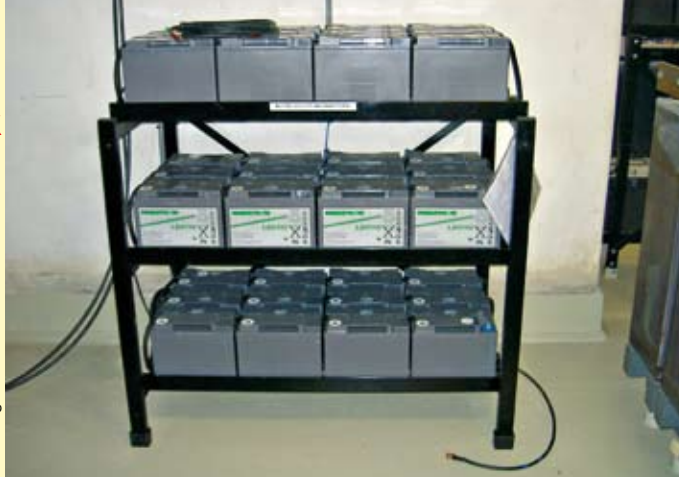
Neue Zentralbatterieanlagen 216 V/110 Ah
