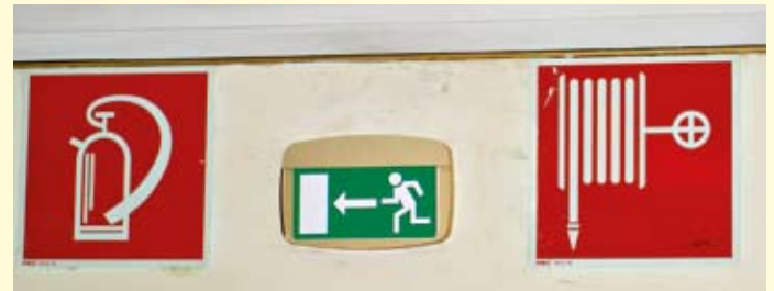
... und neue Notleuchte
