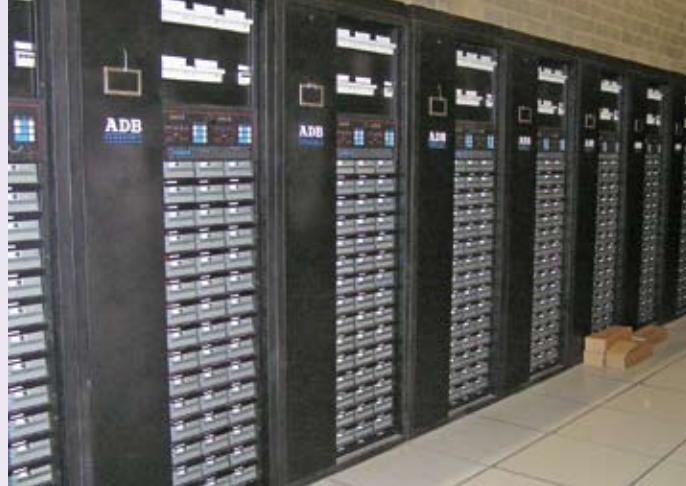
Der zentrale Dimmer-Raum mit den 5 KW Thyristor-Kreisen der Fernsehanstalt „Vlaamse Media Maatschappij“
