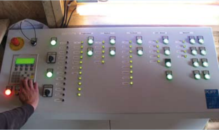
Bedienpult der Augenwand – von hier aus werden 5 Bewegungen gefahren
