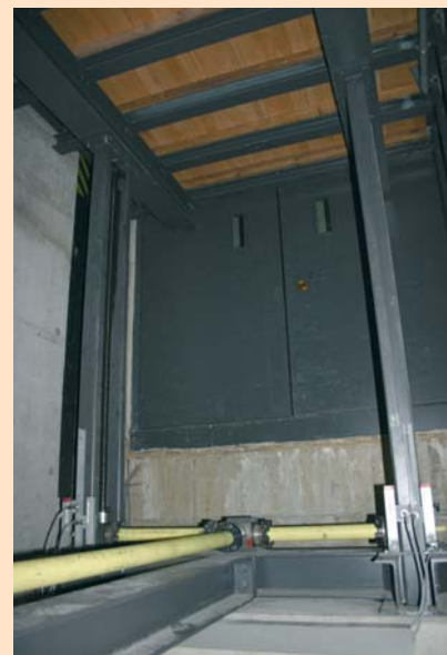
Hubpodium im „Verbindungs-trakt“ zwischen Festspielhaus und Seebuhne (Hubhoe 3.450 mm): Spindeln mit „Belastung auf Zug“
