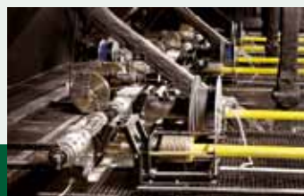
Obermaschinerie des Centrum Kultury Zamek mit Rohrwellenzügen RW-SHIFT 500
