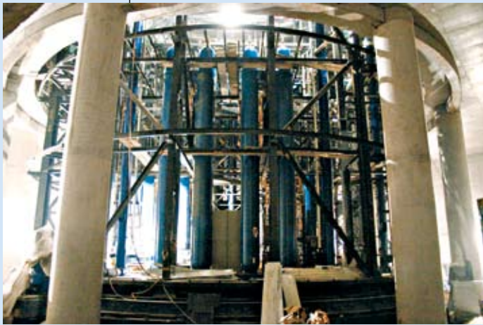
Blick von der Bühnengrube aus auf die gewaltige Drehbühne mit montierten Stickstoffbehältern, Speicherstationen und Hubtischen
