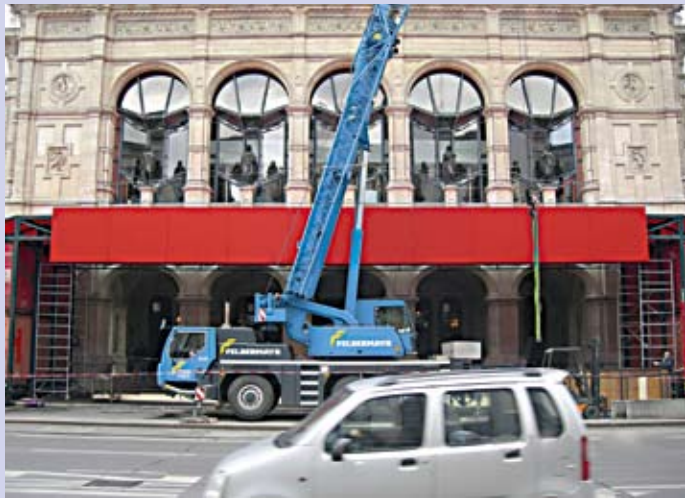
Beginn der Verkleidung der Dachkonstruktion, die links und rechts auf den Containern aufliegt
