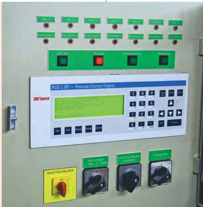
Zentrale Steuereinheit DIGI'Control PCD 1.NT
