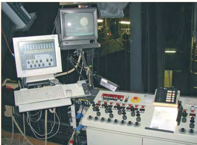
Steuerpult für die Obermaschinerie mit bereits voll bestückter Bedienoberfläche
