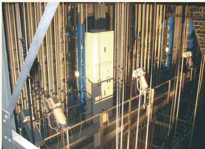
Linke Arbeitsgalerie mit den Handkonterprospektzügen
